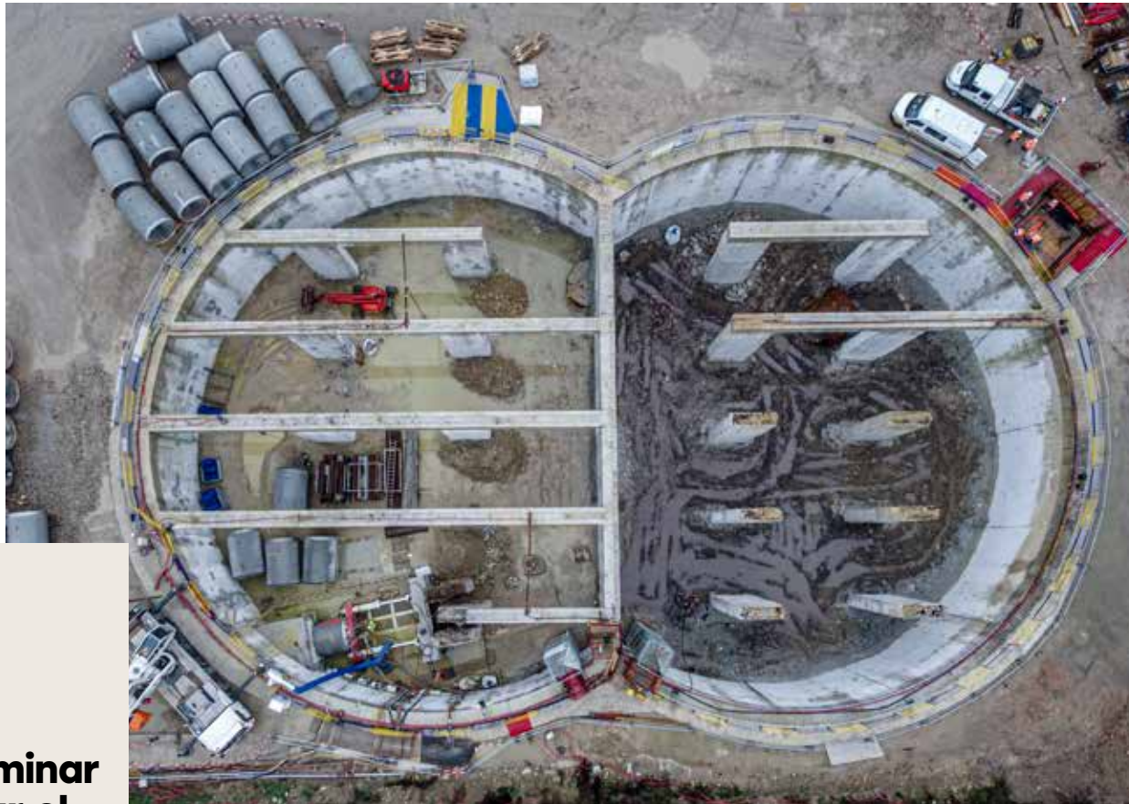
Planta de tratamiento de aguas pluviales en Champigny sur Marne
